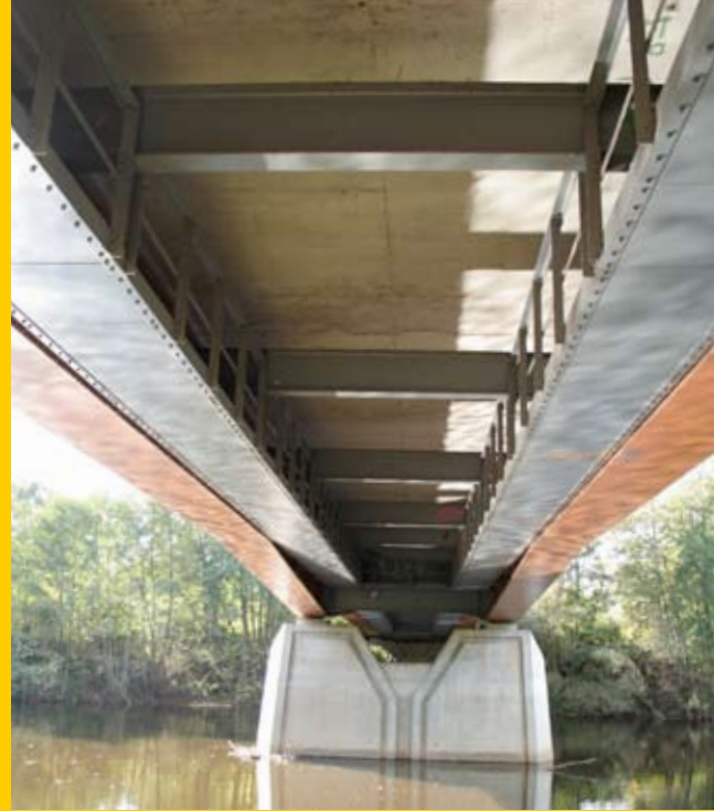
Cet ouvrage hydraulique est composé d'une structure mixte : tablier béton et poutres métalliques.
